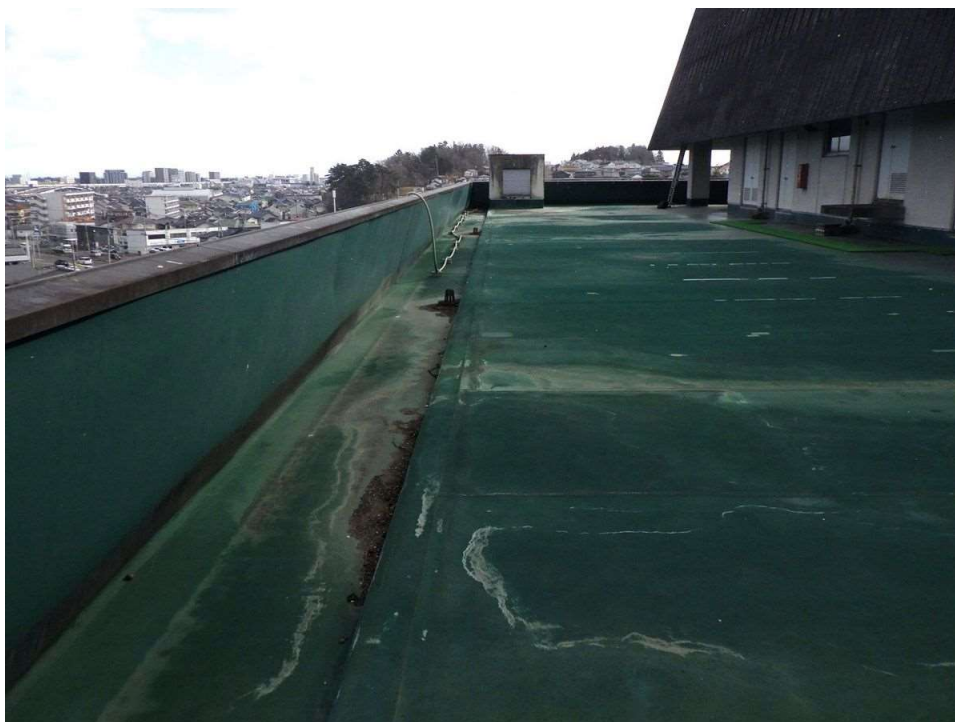
着手前 本館棟 北面 YC5～7・XH6～12
